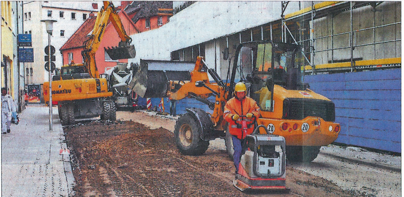
Seit gestern wird im Südteil der Arnekenstraße das Pflaster herausgerissen – doch bis die neue Fahrbahn fertig ist, werden noch Monate vergehen.
