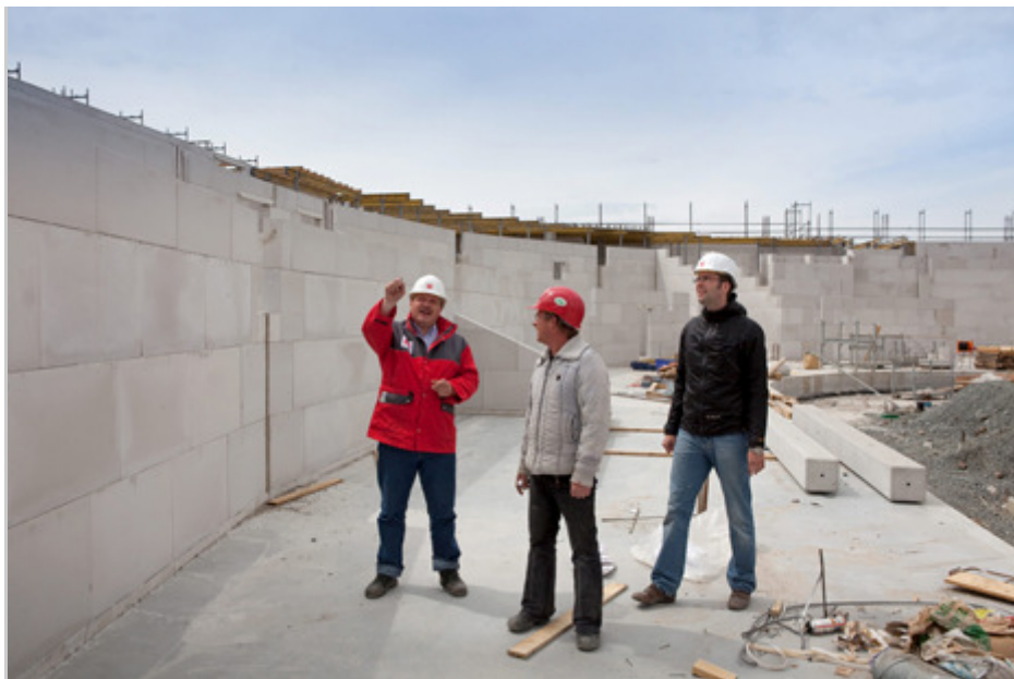
Der Bremer Geschäftsbereich der Köster GmbH erstellt das neue Eisstadion für die Stadthalle Bremerhaven Veranstaltungs- und Messe GmbH Alle Bilder: Köster GmbH
