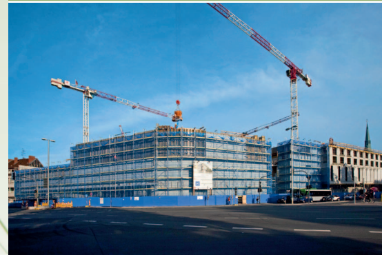
Für die BREEAM-Zertifizierung Prädikat Excellent ist die Arneken Galerie in Hildesheim vorgesehen, die derzeit schlüsselfertig von der Köster GmbH errichtet wird (siehe Seite 7).
